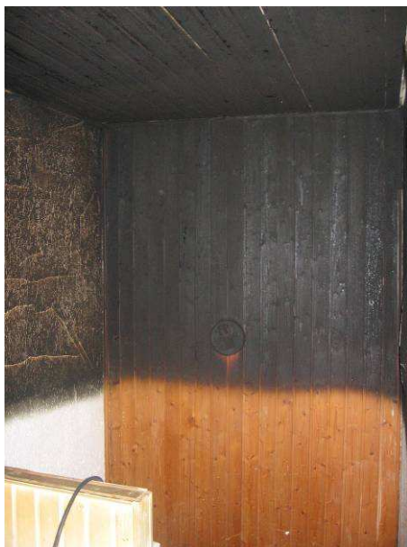
Abb. 73: Der Blick in den Treppenraum des Flügelanbaus. Sehr schön ist hier die scharfe Trennung zwischen der oberen Brandzone, in der die heißen Brandgase die Holzverfärbung pyrolysiert haben und der unteren wesentlich kühleren Zone zu erkennen. Im unteren Teil sind optisch keine Veränderungen am Holz wahrnehmbar.
