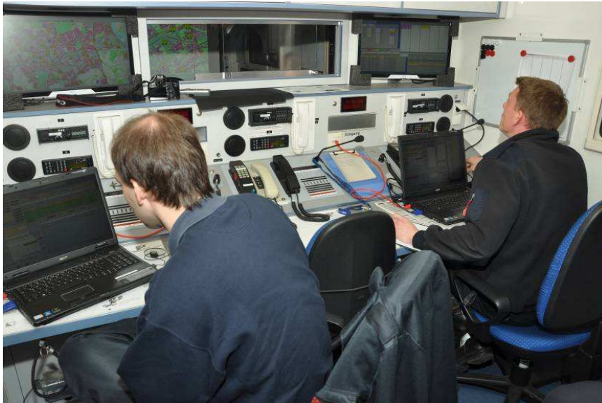
Abb. 7: Zwei Disponentenplätze im Einsatzleitwagen 2, ausgestattet mit Funk, Telefon und Einsatzleitsoftware „Cobra“
