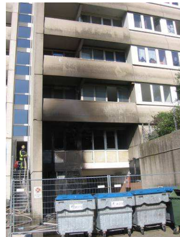
Abb. 67: Deutlich sind die Brandspuren bis zu vier Geschosse höher noch zu erkennen.
