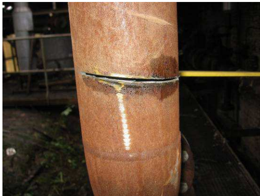
Abb. 58: Diese Gasleitung war noch in Betrieb, als die Abbrucharbeiten begannen und die Handwerker versuchten das Rohr zu durchtrennen.
