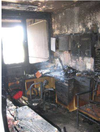
Abb. 68: Aus dem vermeintlichen Sperrmüllbrand wurde schnell ein Wohnungsbrand mit enormer Rauchausbreitung im Gebäude.
