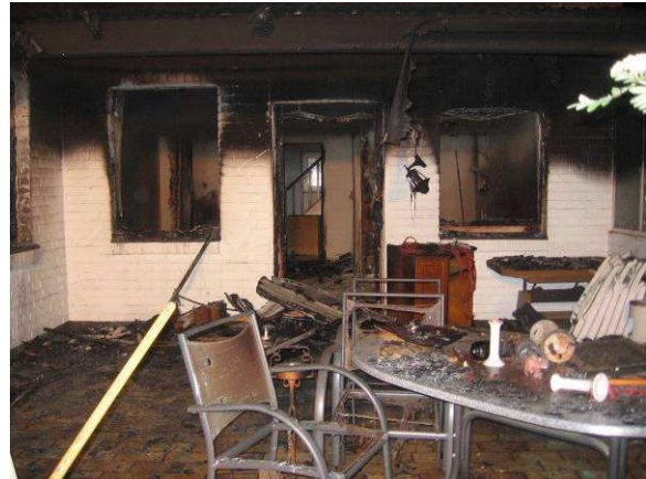
Abb.65: Die Wärmeentwicklung war so groß, dass alle Fenster geborsten sind.
