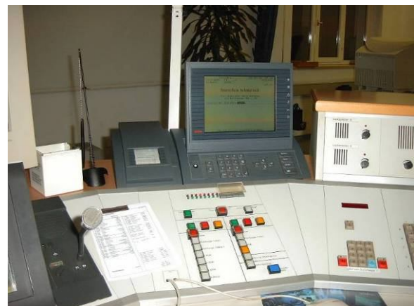
Einsatzleitplatz mit einem UGM 2020 Bedienterminal
